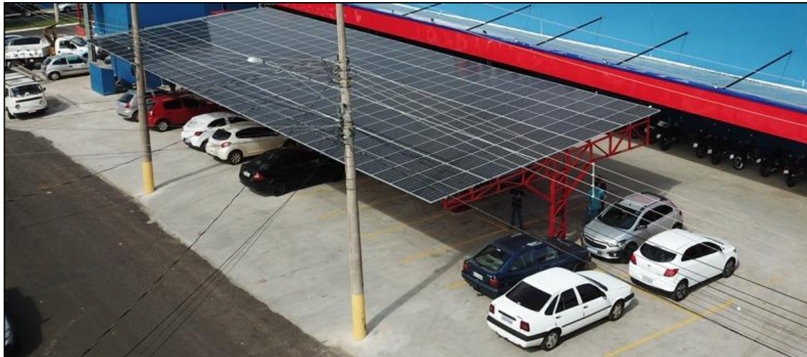
Figura 3. Módulos Fotovoltaicos sobre o CARPORT SOLAR
