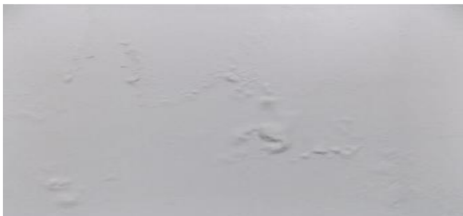
Figura 4: Bolhas causadas pela umidade Fonte: Montecielo (2016)
