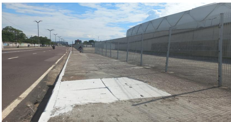
Figura 3: Tampa de esgoto e rachaduras na calçada. Fonte: Autoria Própria (2022).
