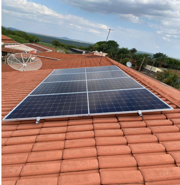
Figura 6 – Placa fotovoltaica Fonte: própria (2022).
