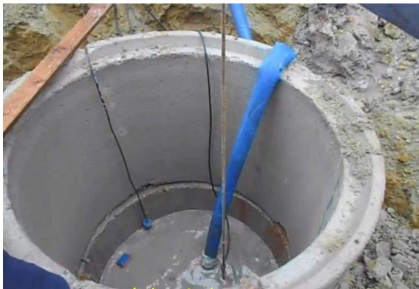
Figura 3: Drenagem da água no local da obra (a água era desviada para a rua) Fonte: autor
