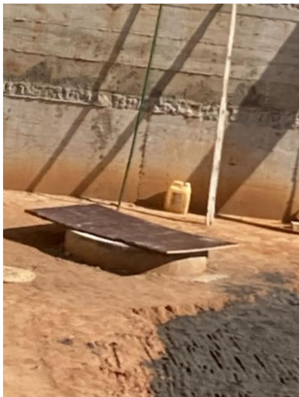
Figura 1: Poço de drenagem Fonte: autor
