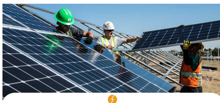
Figura 2 – Painéis solares fotovoltaicos Fonte: PORTALSOLAR
