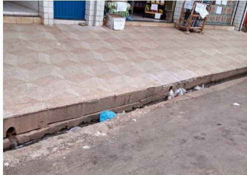
Figura 2 – Esgoto a céu aberto próximo a frigoríficos.
