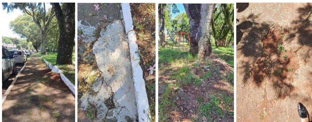
Figura 2: Patologias nos passeios externos ou de contorno
