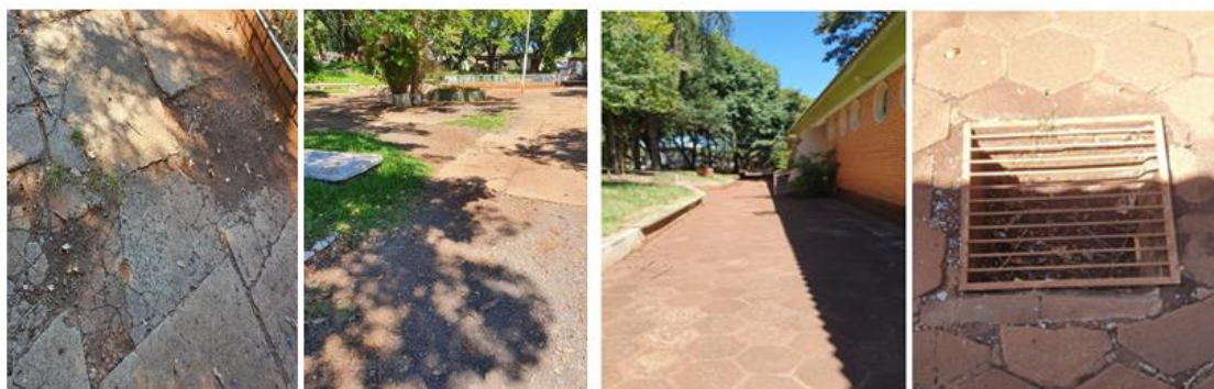
Figura 4: Patologias no Trecho 4
