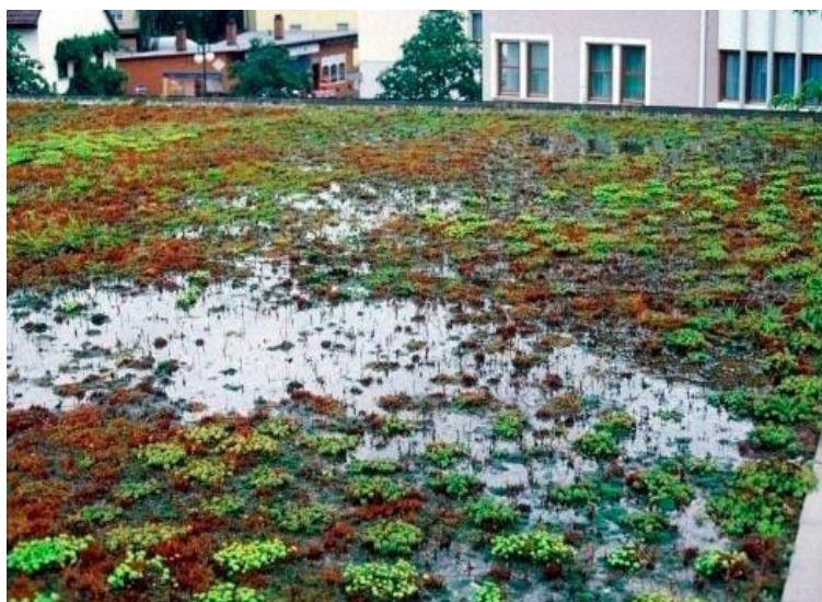
Figura 7 – Telhado verde com problemas de encharcamento e sobre carga Fonte: Palha et al. (2012) apud Prates (2012)
