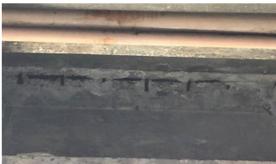
Figura 4 - Lajes- Corrosão de Armadura Fonte: Gaspar (2021) p. 47
