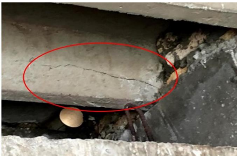
Figura 3 - Viga de sustentação- Fissura Horizontal Fonte: Gaspar (2021) p. 42
