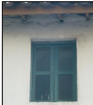
Figura 12. Trincas resultante pelo recalque das fundações (Fonte: autor)
