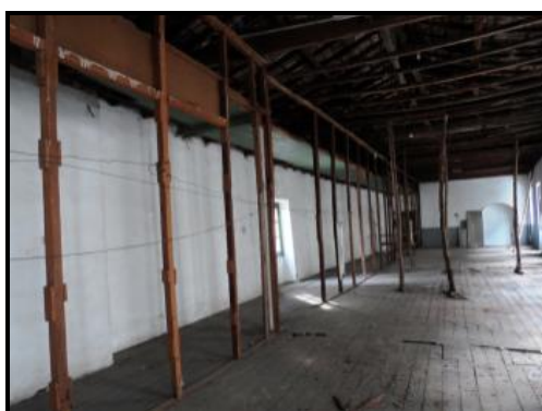
Figura 17. Deslocamentos dos barrotes transversais (Fonte: autor)
