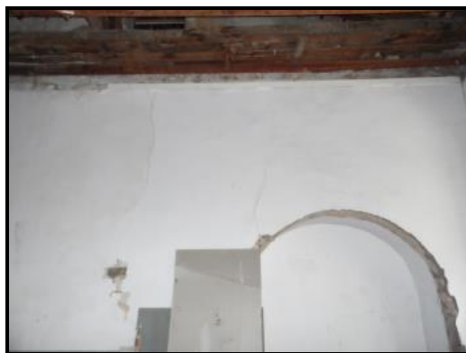
Figura 14. Desprendimento do revestimento do arco (Fonte: autor)
