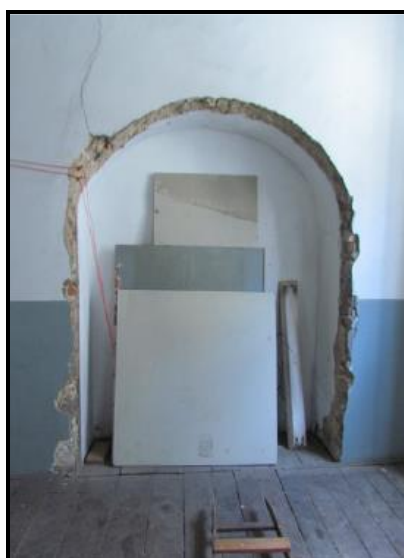
Figura 15. Desprendimento pela má execução da argamassa (Fonte: autor)
