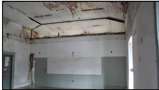
Figura 19. Apodrecimento da madeira do teto e desprendimento do revestimento da parede pela oxidação da barra de ferro (Fonte: autor)
