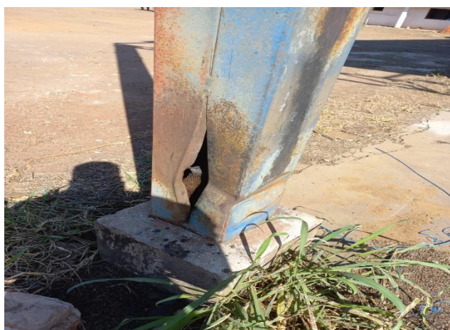
Figura 3-Pilar metálico danificado Fonte: o autor, 2023
