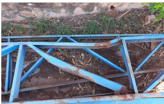
Figura 2- Tesoura Metálica danificada Fonte: O autor, 2023
