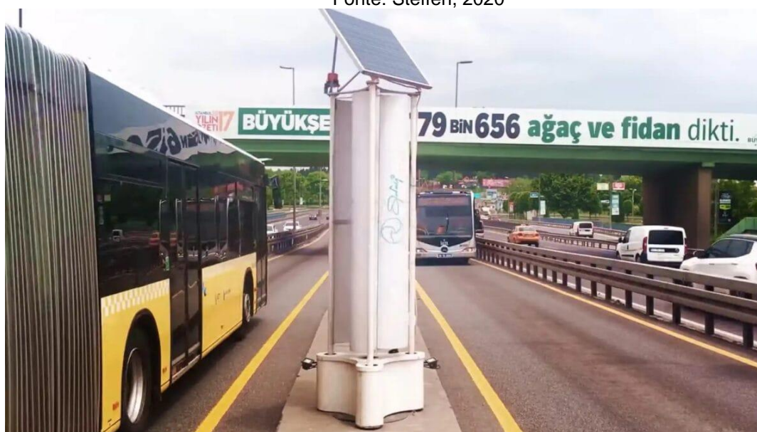
Figura 7 - Turbina eólica instalada no centro de uma rodovia Fonte: Medeiros, 2024
