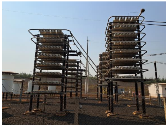
Figura 2 – Exemplo de banco de capacitores de um sistema de transmissão HVDC
