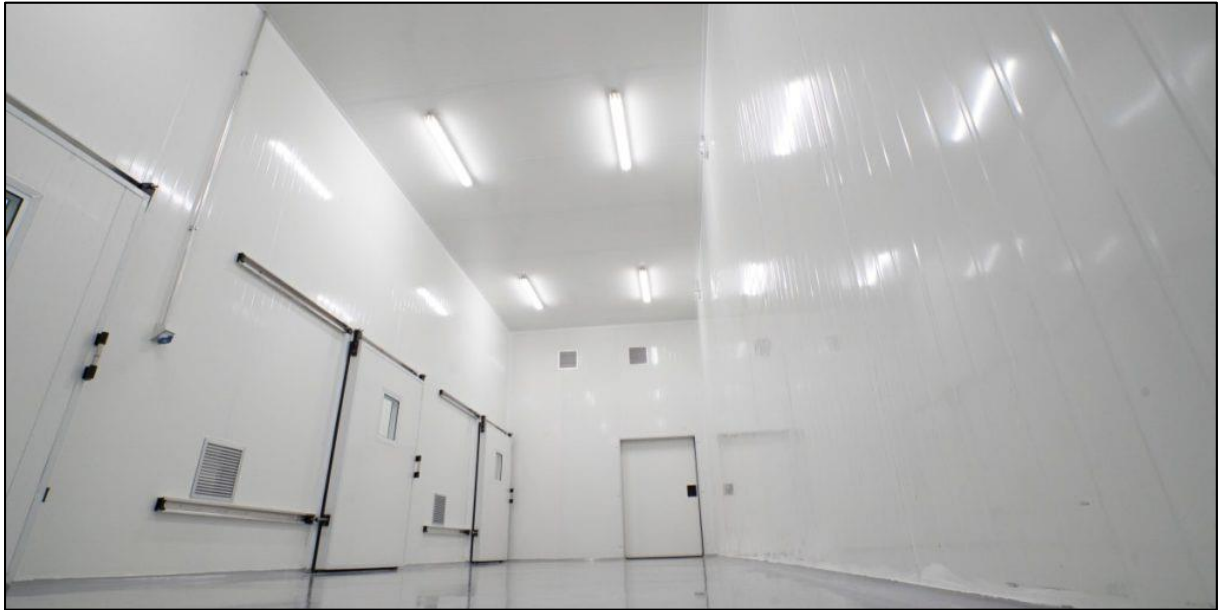
Figura 2: Câmara fria apropriada para armazenamento de FLV's
