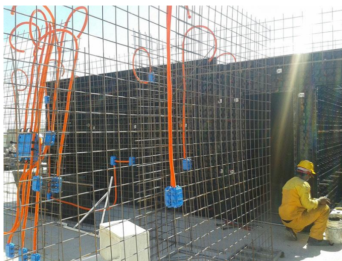
Figura 7 - Instalações elétricas Fonte: (MODULAR, 2021)
