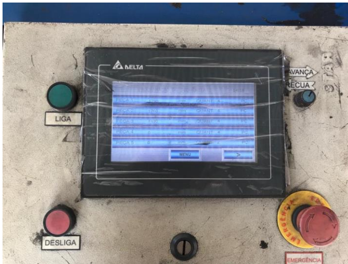
Figura 5 - Painel da máquina de corte de aço Fonte: (AUTOR, 2021)
