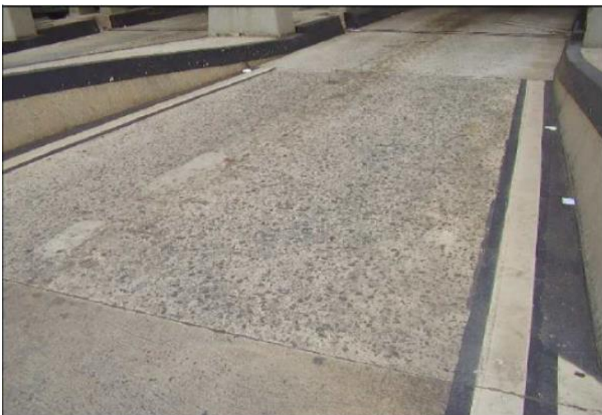
Fig. 2. Desgaste superficial por abrasão em pavimento de concreto. Fonte: (SANTOS, 2012:14, 2021)
