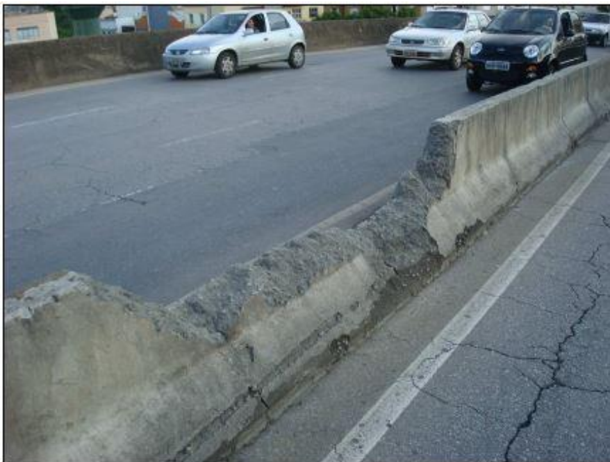
Fig. 1. Guarda-rodas rompido por batida de veículos em viaduto de Belo Horizonte (MG). Fonte: (SANTOS, 2012:11, 2021)
