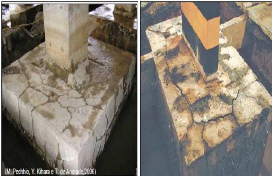
Fig. 3. Reação álcali-agregado em blocos de fundação de edifícios em Recife (PE) Fonte: SANTOS, 2012:33.
