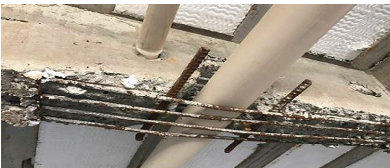
Figura 9: Incompatibilidade de projeto estrutural e hidráulico Fonte: (AUTOR PRÓPRIO, 2021)
