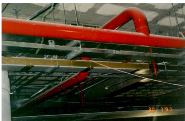
Figura 7: Incompatibilidade entre projetos elétrico e de combate à incêndio Fonte: (MAISENGENHARIA, 2021)
