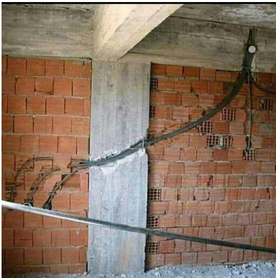
Figura 8: Incompatibilidade entre projetos elétrico e estrutural Fonte: (MAISENGENHARIA, 2021)
