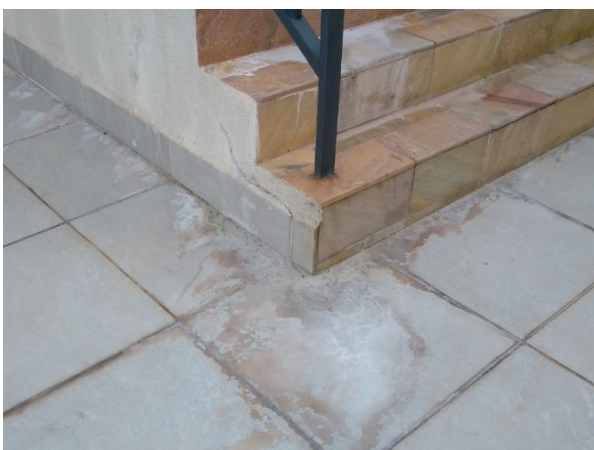
Figura 2 - Eflorescência em piso. Fonte: (TOTALCONSTRUCAO, 2021)
