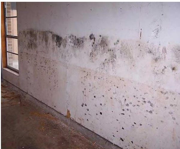
Figura 4 - Infiltração em parede devido a ruptura de tubulação. Fonte: (HOME, 2021)
