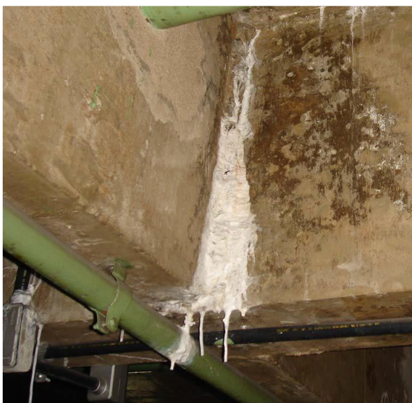
Figura 3 - Eflorescência no encontro das vigas em garagem Fonte: (PRPPG, 2021)
