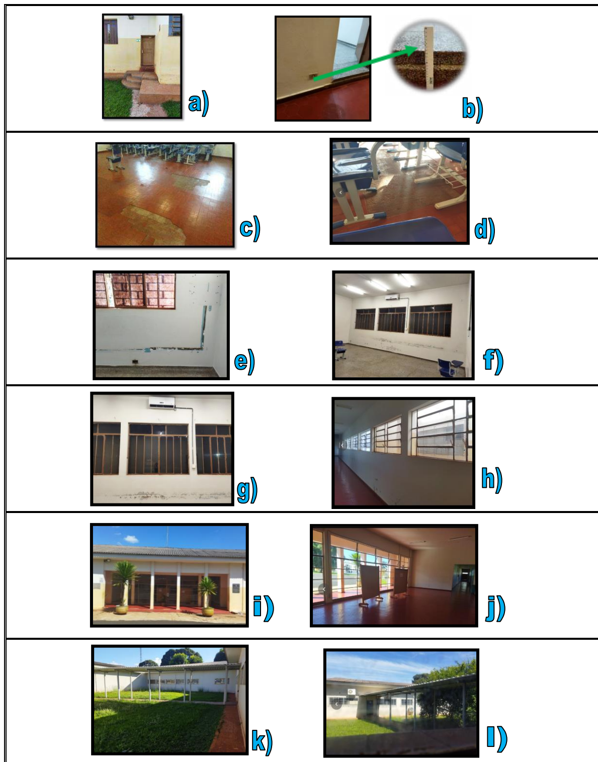
Figura 2 _a, b, c, d, e, f, g, h, i, j, k, l, Patologias e análises verificadas no pavilhão. Fonte: Autor.
