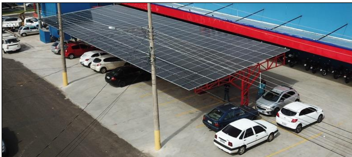
Figura 3. Módulos Fotovoltaicos sobre o CARPORT SOLAR
