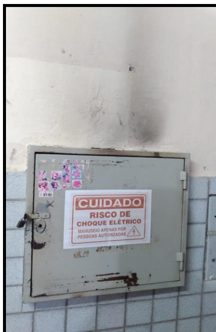
Figura 7 – Quadro de distribuição dos circuitos terminais.
