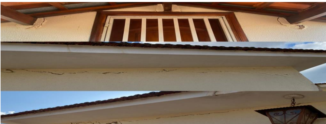
Figura 4: Trincas horizontais causadas pelo recalque da fundação. Fonte: (AUTORIA PRÓPRIA)
