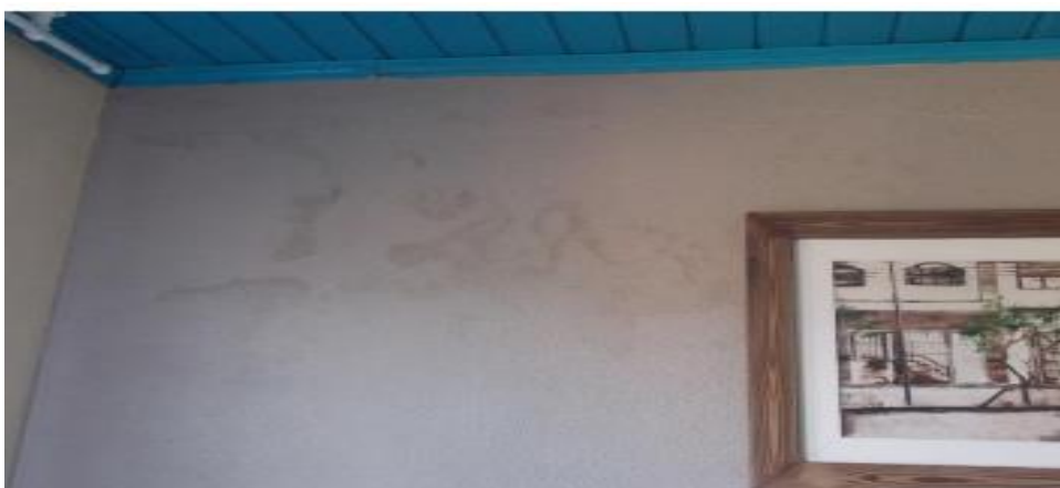
Figura 3: Manchas causadas pela umidade Fonte: Montecielo (2016)
