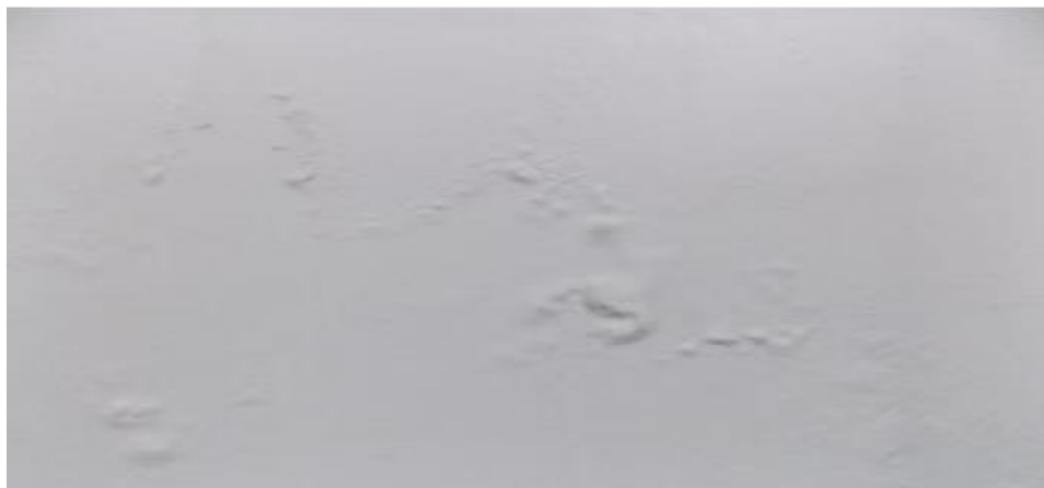
Figura 4: Bolhas causadas pela umidade Fonte: Montecielo (2016)
