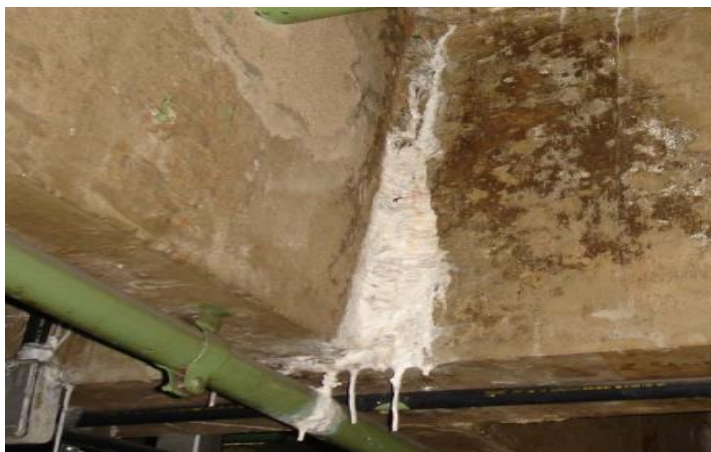
Figura 2: Eflorescência em encontro de vigas em pavimento de garagem Fonte: Souza (2008)
