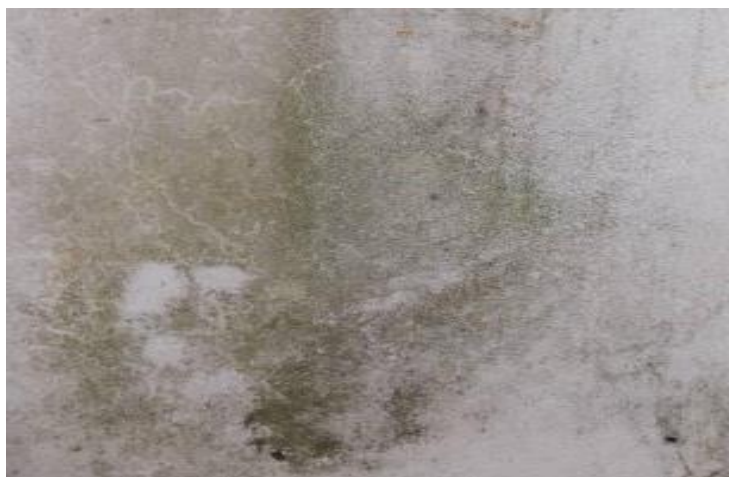
Figura 1: Mofo provocado pelo excesso de umidade Fonte: Montecielo (2016)
