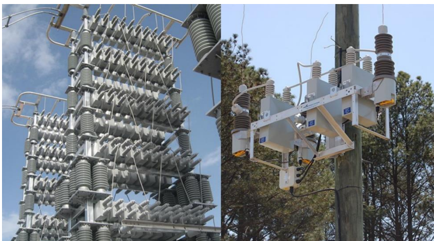
Figura 1 – Banco de capacitor de subestação e banco de capacitor de distribuição
