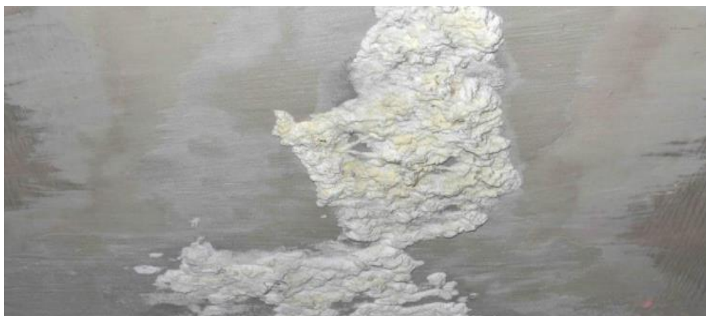
Figura 10: Eflorescência Fonte: Gonçalves et al. (2021)
