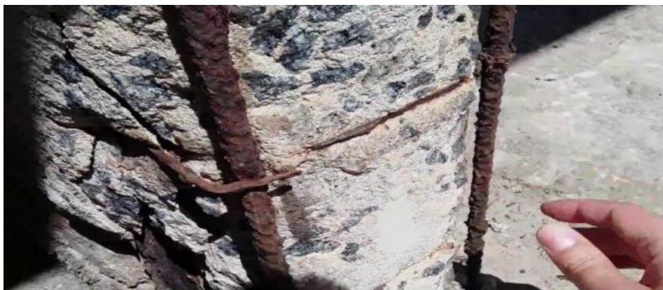
Figura 9: Corrosão de uma armadura devido à infiltração Fonte: Gonçalves et al. (2021)
