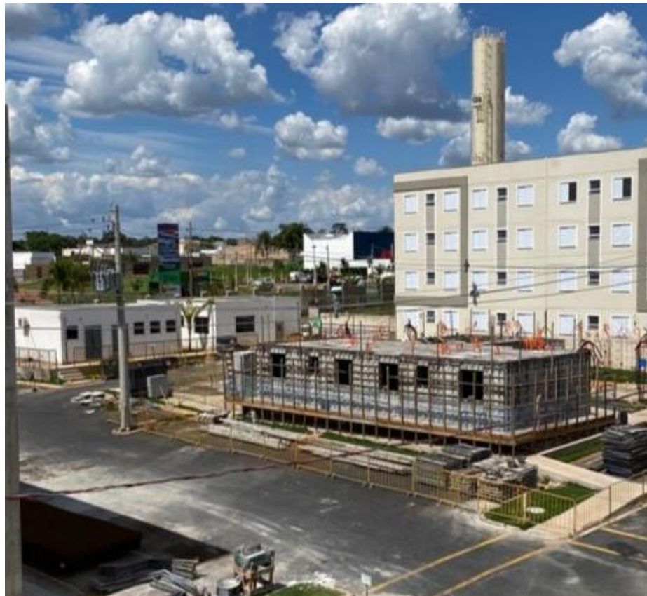
Figura 2: Edificação por meio de parede de concreto moldada no local Fonte: próprio autor (2022)
