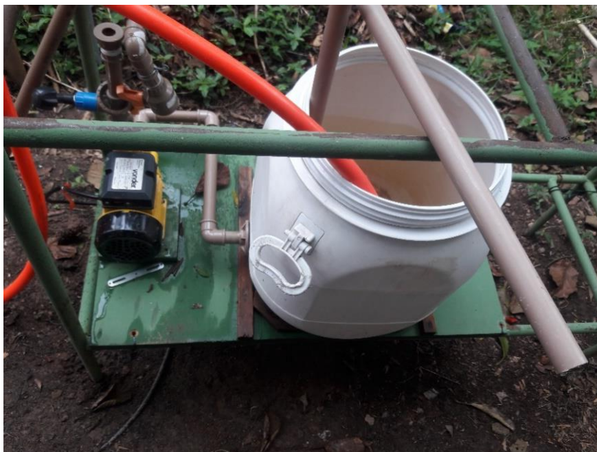
Figura 4 - Bomba e Reservatório de Água
