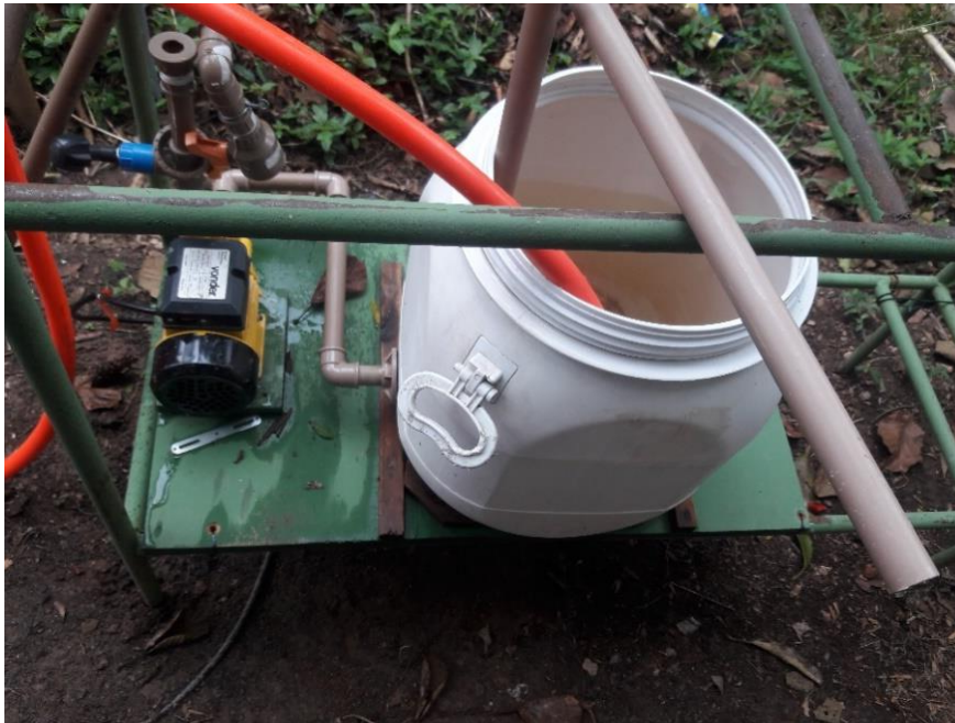
Figura 4 - Bomba e Reservatório de Água
