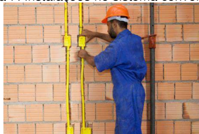
Figura 7: Instalações no sistema convencional
