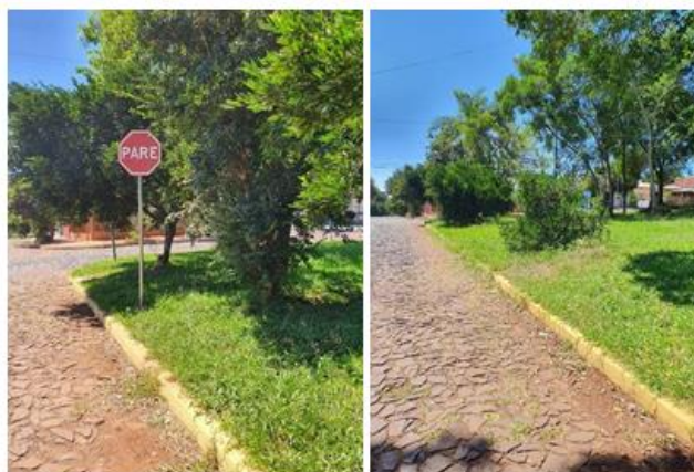
Figura 3: Área sem pavimento no passeio
