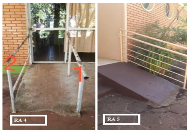
Figura 2: RAs às edificações
