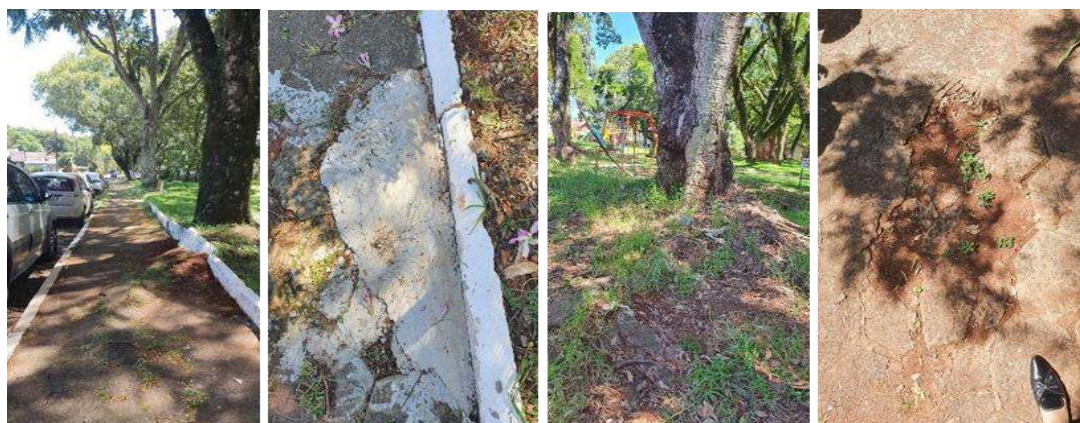
Figura 2: Patologias nos passeios externos ou de contorno
