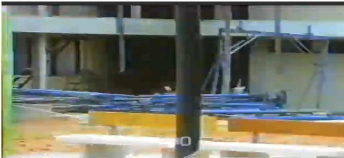
Figura 2 – Vista da área de construção da Escola Técnica Federal de Manaus – UNED 1990
