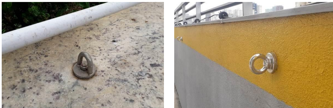
Figura 26 - Dispositivos de ancoragem para segurança em trabalho à altura (Conforme orientações da NR18 e NR35).
