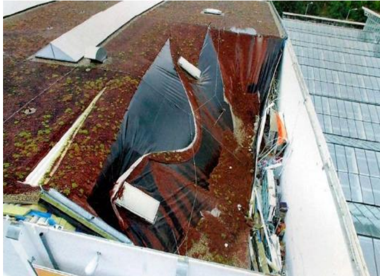
Figura 8– Colapso da estrutura devido à sobrecarga Fonte: Palha, Contreras e Pereira (2012) apud Prates (2012)
