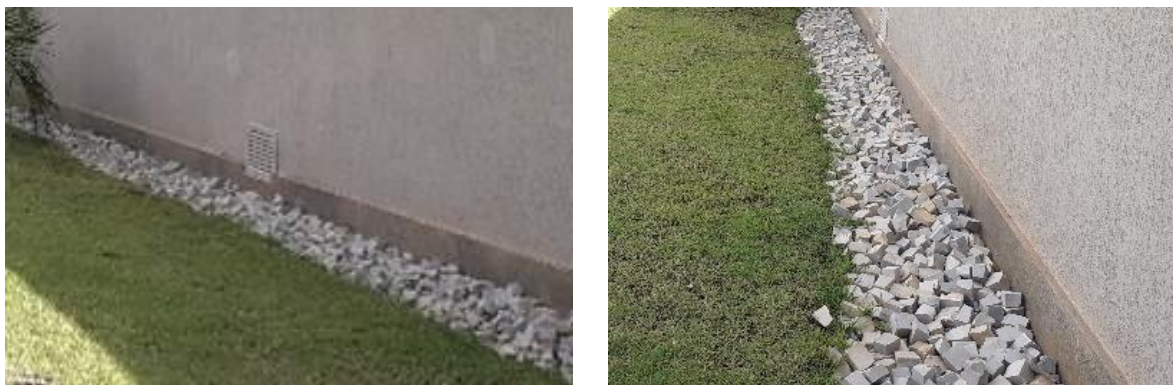
Figura 24 - Distanciamento da vegetação dos planos verticais com material granular.
