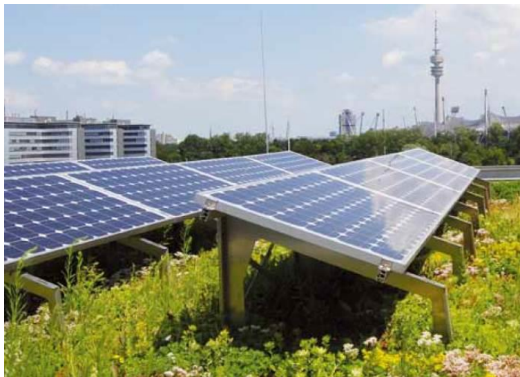
Figura 5 - Interação de painéis de energia solar em telhado verde Fonte: Zinco (2019)
