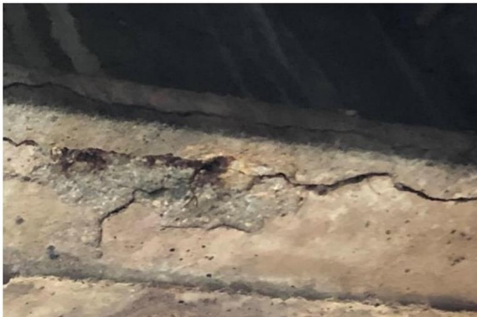
Figura 5 - Lajes- Fissura e Corrosão de Armadura Fonte: Gaspar (2021) p. 47
