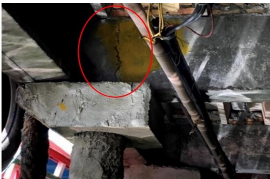
Figura 2 - Viga de sustentação- Trinca Vertical Fonte: Gaspar (2021) p. 42
