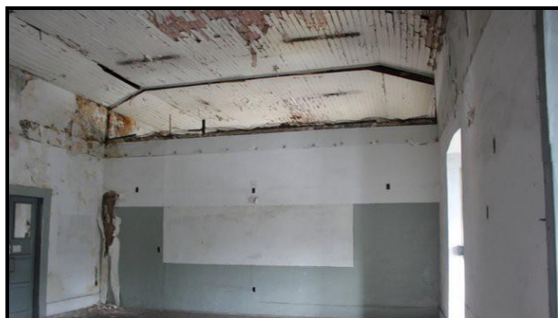
Figura 19. Apodrecimento da madeira do teto e desprendimento do revestimento da parede pela oxidação da barra de ferro (Fonte: autor)
