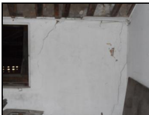
Figura 13. Trincas resultantes do emprego de materiais impróprios (Fonte: autor)
