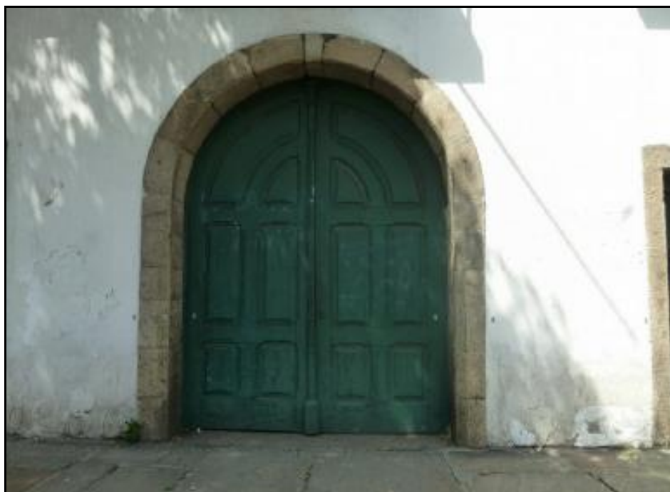
Figura 9. Antigo Convento do Carmo. Porta de acesso principal, almofadada e com verga de arco pleno; todo o enquadramento é em trabalho de contaria com granito. Pça XV de Novembro, Rio de Janeiro/RJ. Dezembro/2013 (Fonte: autor).
