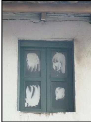
Figura 11. Trincas observadas pela acomodação da parede (Fonte: autor)
