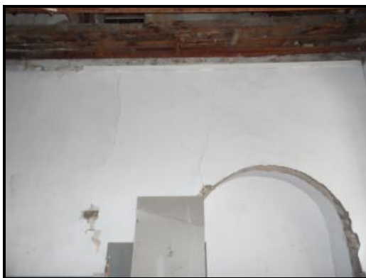
Figura 14. Desprendimento do revestimento do arco (Fonte: autor)
