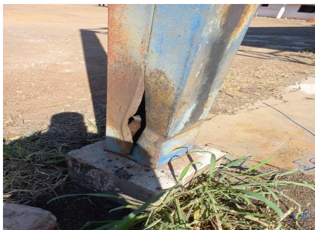
Figura 3-Pilar metálico danificado Fonte: o autor, 2023
