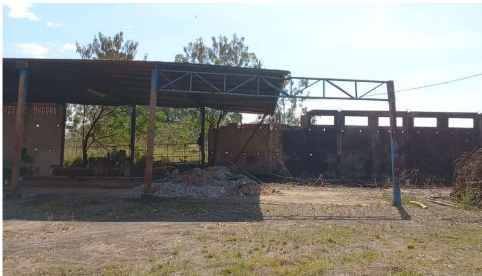
Figura 1 - Situação inicial da estrutura metálica Fonte: O autor, 2023
