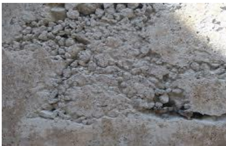
Figura 04 - Manifestação patológica - segregação do concreto (bicheira no concreto)
