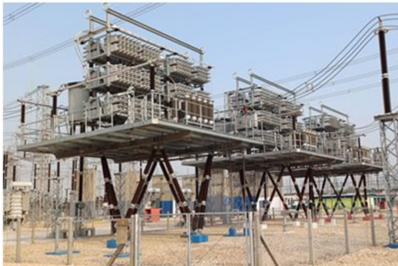
Figura 1 – Exemplo de banco de capacitores série Fonte: Próprio autor.
