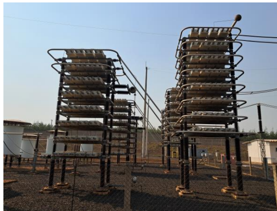
Figura 2 – Exemplo de banco de capacitores de um sistema de transmissão HVDC
