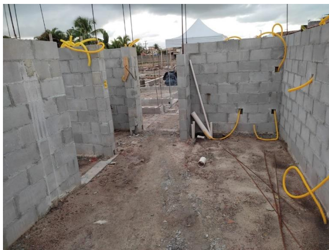
Figura 8. Pontos elétricos fora da posição prevista em projeto
