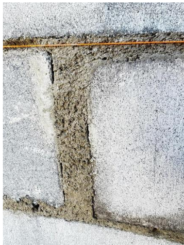
Figura 3. Desalinhamento acentuado em parede estrutural
