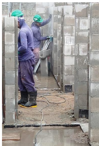
Figura 10. Parede recém-levantada após chuva intensa, evidenciando saturação dos blocos
