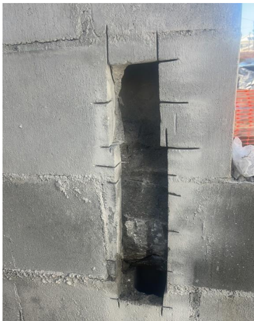
Figura 7. Ponto de graute obstruído, demandando limpeza manual
